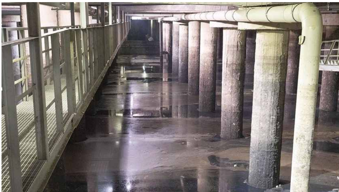
Un tanque de tormentas del Canal de Isabel II. / Canal de Isabel II
